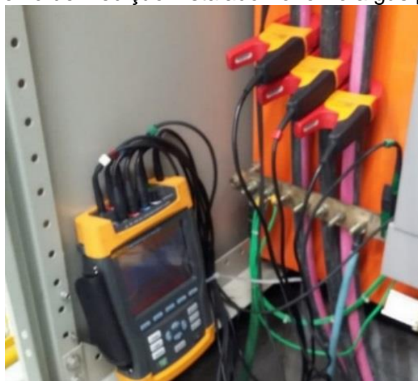
Figura 11: Aparelho de medição instalado no forno a gás [Do autor, 2018].
