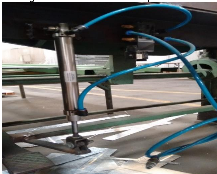
Figura 12: Válvula e atuador pneumático.
