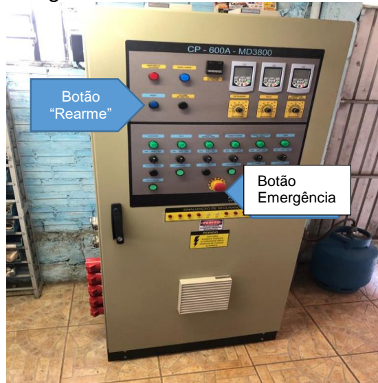
Figura 11. Painel Elétrico Externo.
