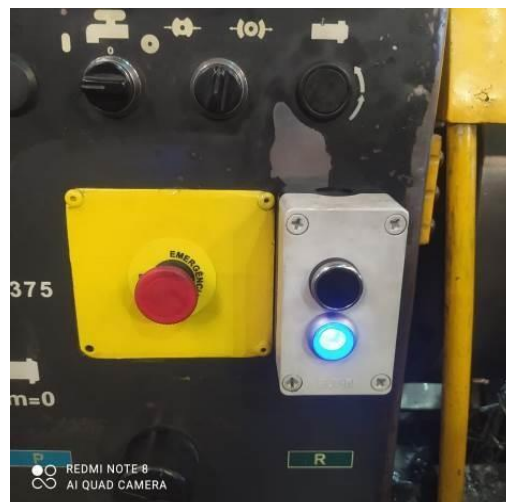
Figura 10: Botão de emergência.
