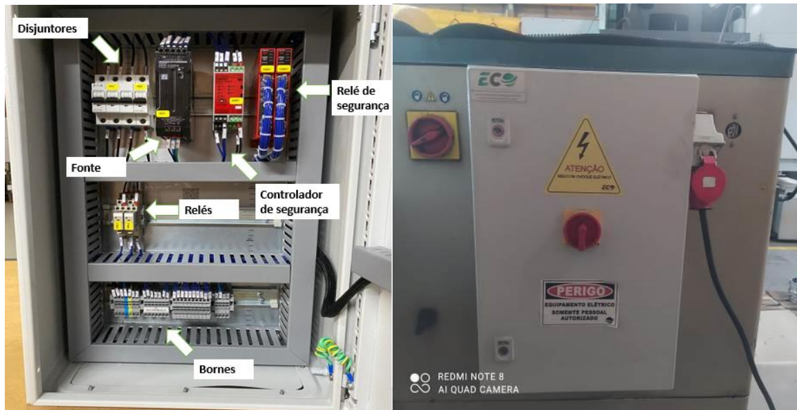
Figura 11: Painel elétrico adequado.
