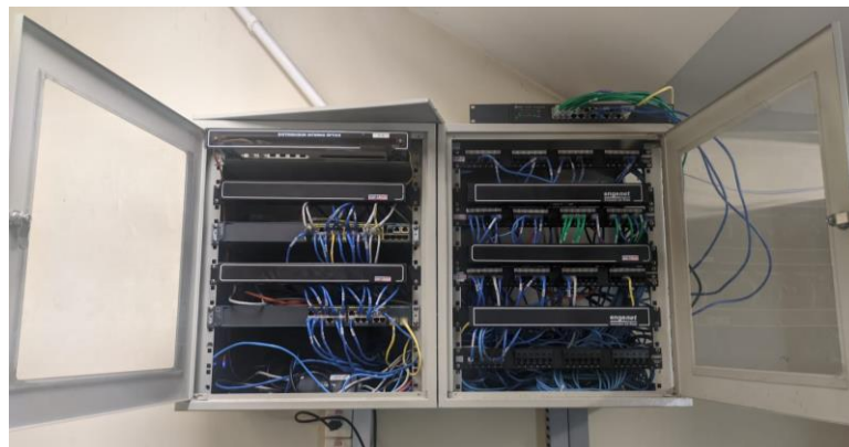
Figura 6: Rack aéreo onde chega à fibra óptica no prédio 24.
